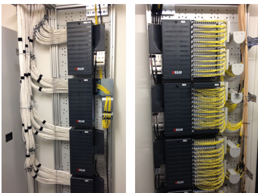
Racks med splidseunits. (Tv. lokalsplidserum) (Th. Hovedsplidserum)
