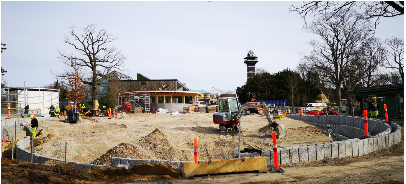
Der arbejdes på anlæg af Verdenspladsen, bambuskøler og pandabutik ifbm åbning af nyt pandaanlæg i ZOO. Foto: Spangenberg & Madsen A/S
